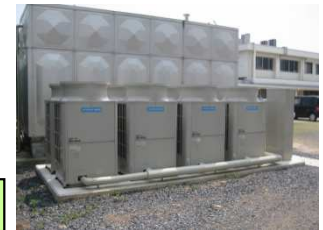
電気式ヒートポンプ空調機
